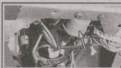
7.5 Прерыватель расположен под блоком плавких предохранителей
