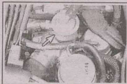
13.1б На двигателях 2,6 л топливный фильтр смонтирован рядом с карбюратором
